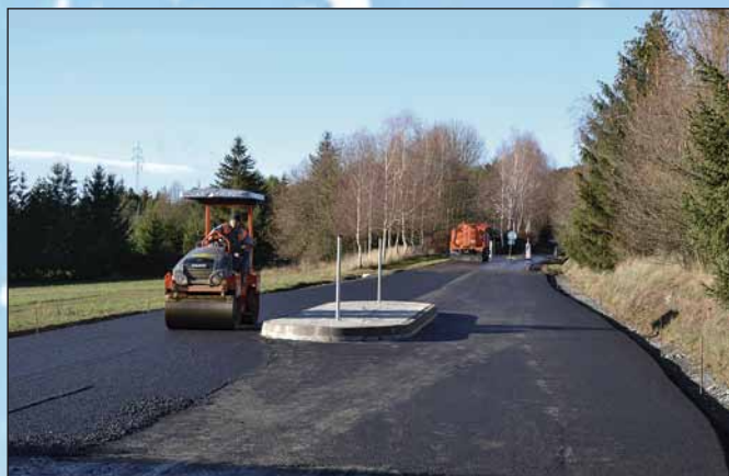
Opatření ke zvýšení bezpečnosti v ulici Vlašimská – asfaltace povrchu; foto archiv města
