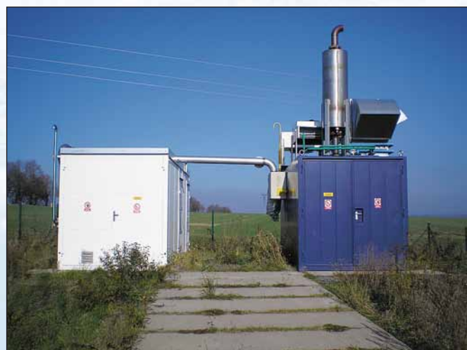
Vlevo čerpací stanice skládkového plynu. Vpravo kontejner se spalovacím motorem a generátorem; foto Ing. Roman Farion
